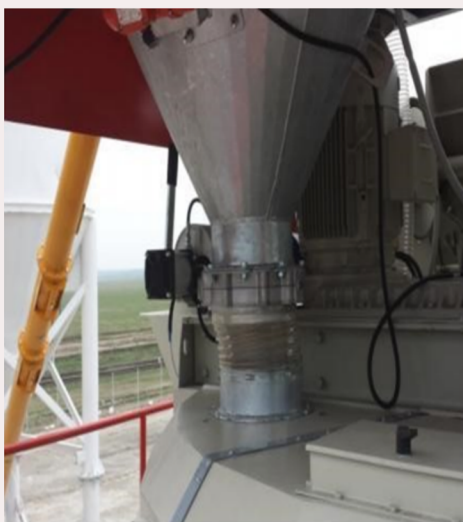
L'équipement de pesage du ciment
